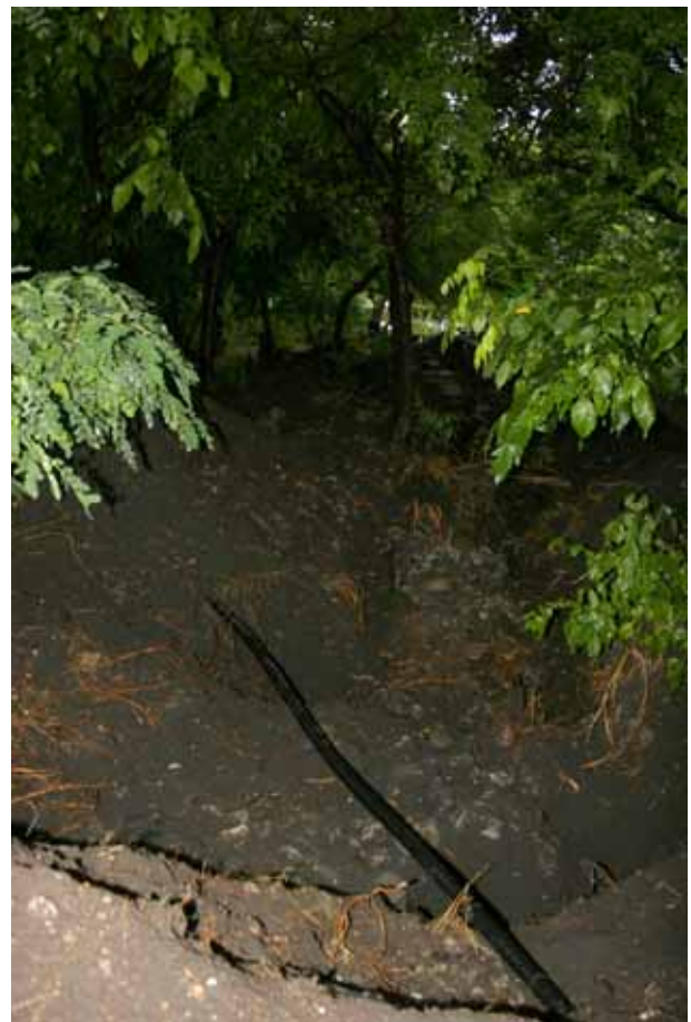
Un câble électrique traverse le revêtement à 0,50 mètres de profondeur
